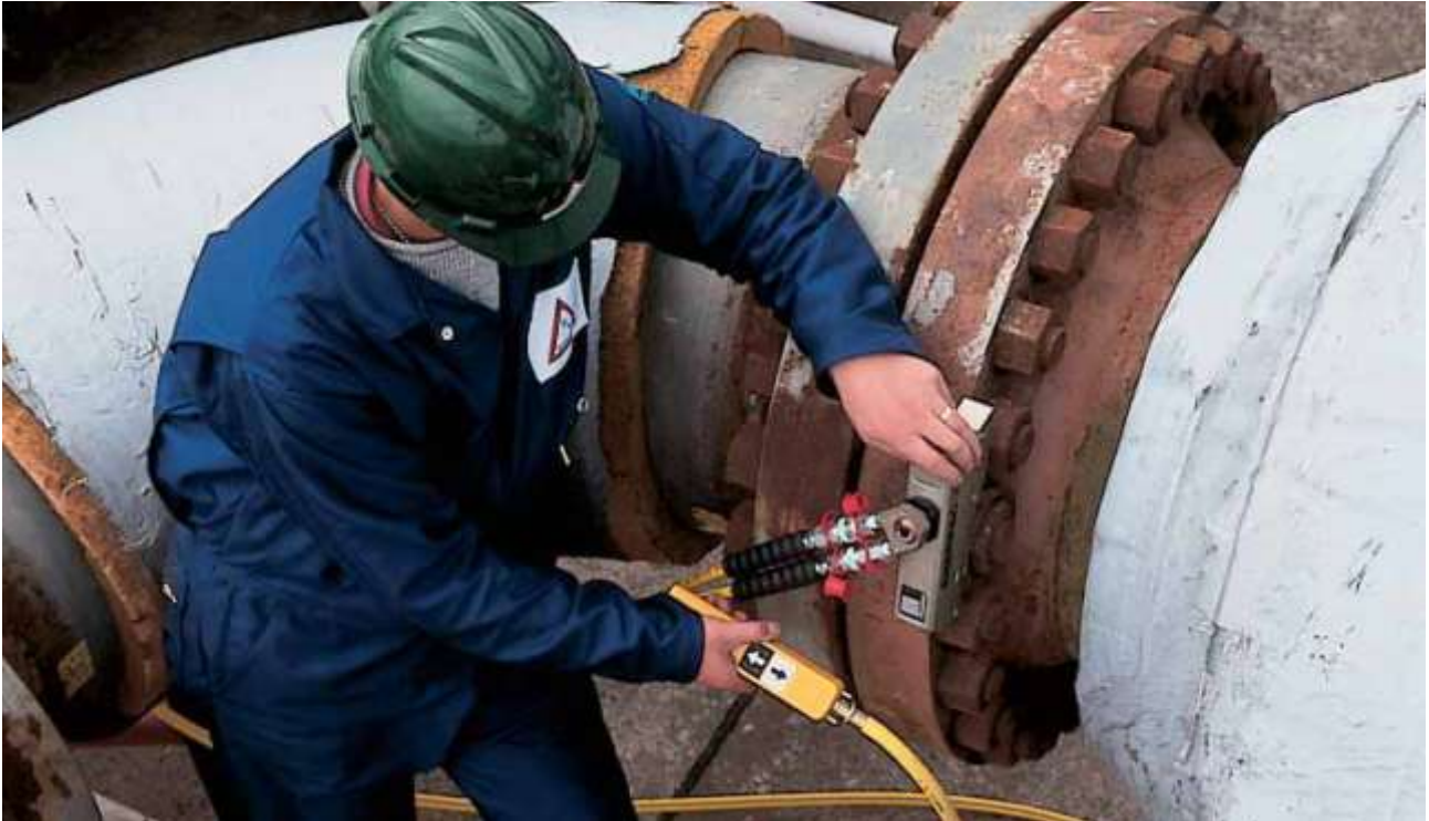
Mit einem hydraulischen Drehmomentschlüssel kann die Bolzen-/Mutterverbindung entsprechend der Anforderungen des Herstellers mit der entsprechenden Vorspannung im Bolzen kontrolliert fixiert werden.
